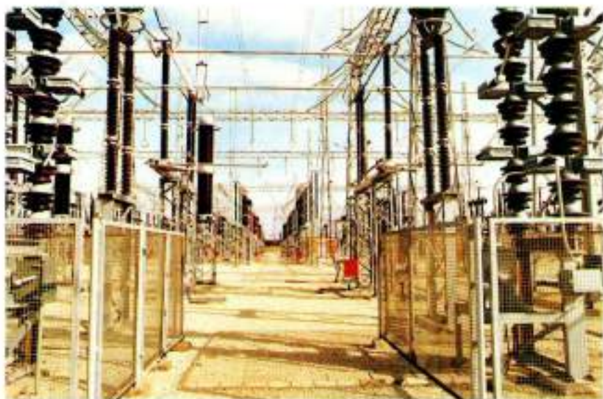
Figura 31. Vista parcial de la subestación de Morata, donde está instalado el sistema experimental TRACOF ®
