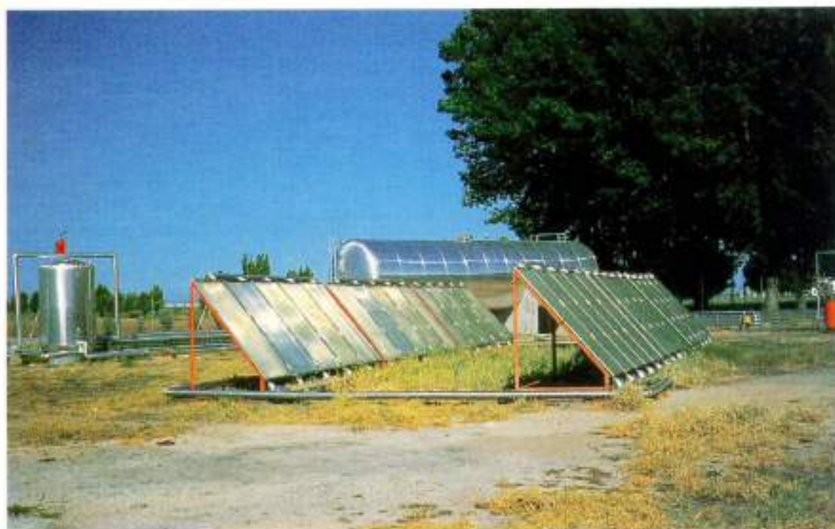
Paneles solares de apoyo energético a una instalación de biogás.
