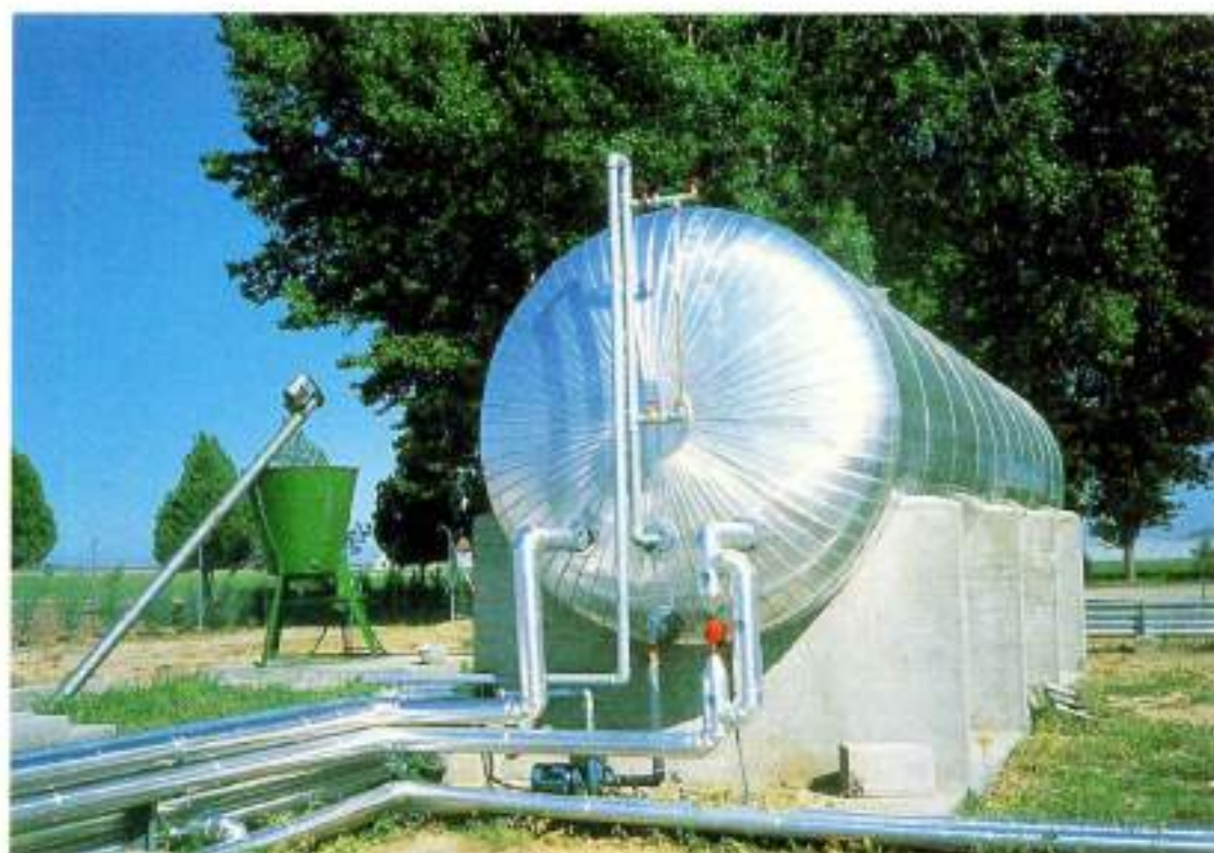
Digestor para la producción de biogás a partir de residuos agrarios.
