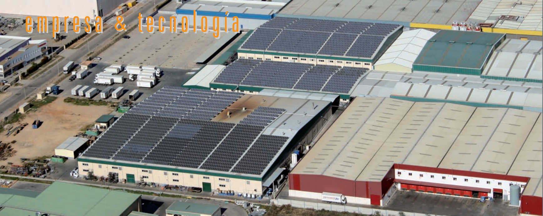
Instalación fotovoltaica de conexión a red sobre cubierta 360 Kw en Dos Hermanas (Sevilla)
