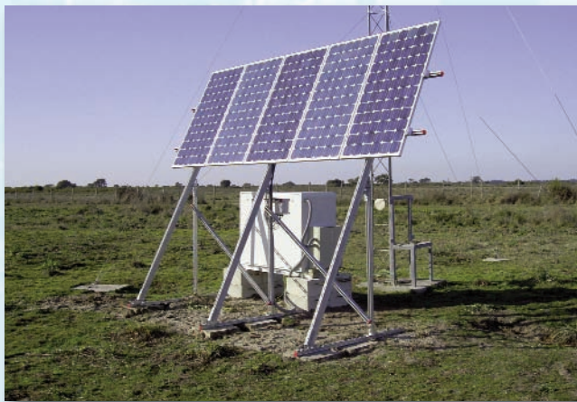
Instalación fotovoltaica aislada en Doñana
