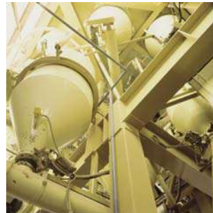
Silos de almacenamiento y dosificación
