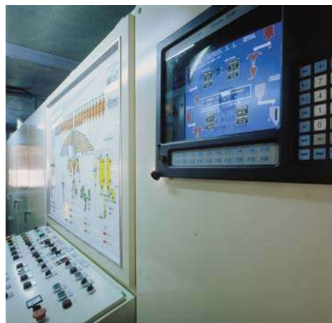
Panel de control automatizado para la fabricación de monolíticos
