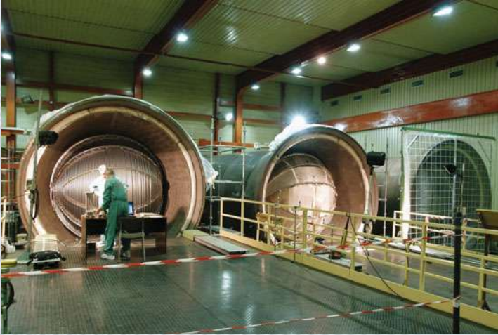
Vista general del área limpia de generadores de vapor
