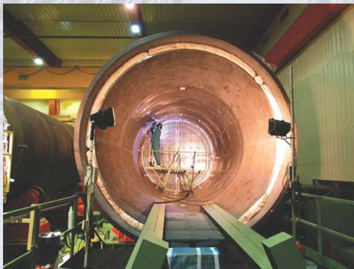
Soldadura de cuñas de fijación en placas soportes de tubos de un generador de vapor
