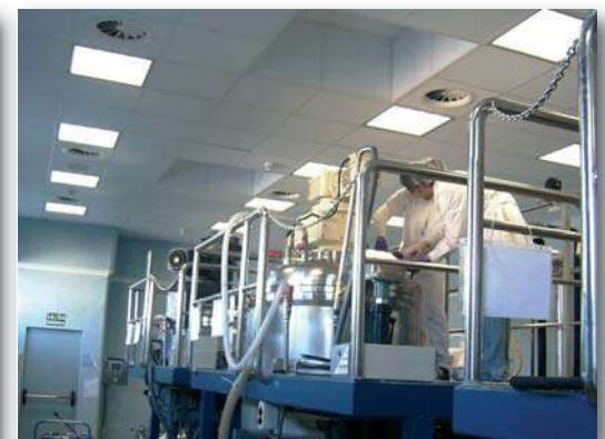
Instalaciones de GP Pharm
