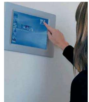
La Plataforma Digital de Hogar Digital gestiona de forma unificada todas las redes y sistemas domóticos de una vivienda
