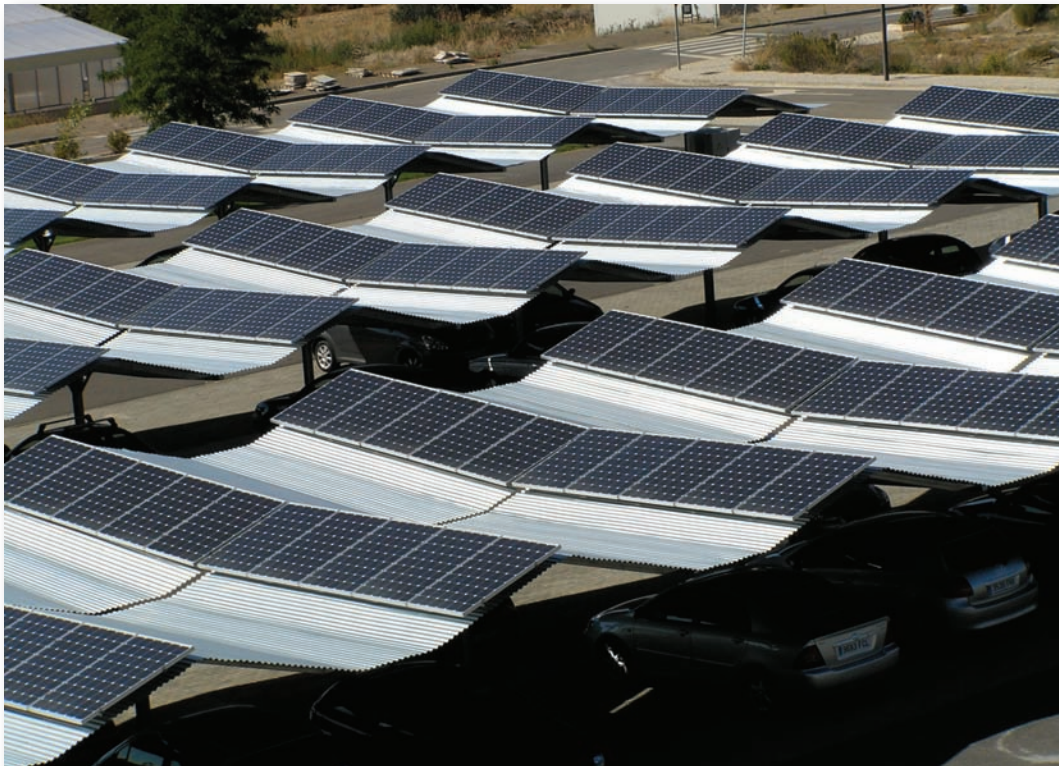
Aplicación de paneles fotovoltaicos en aparcamiento exterior
