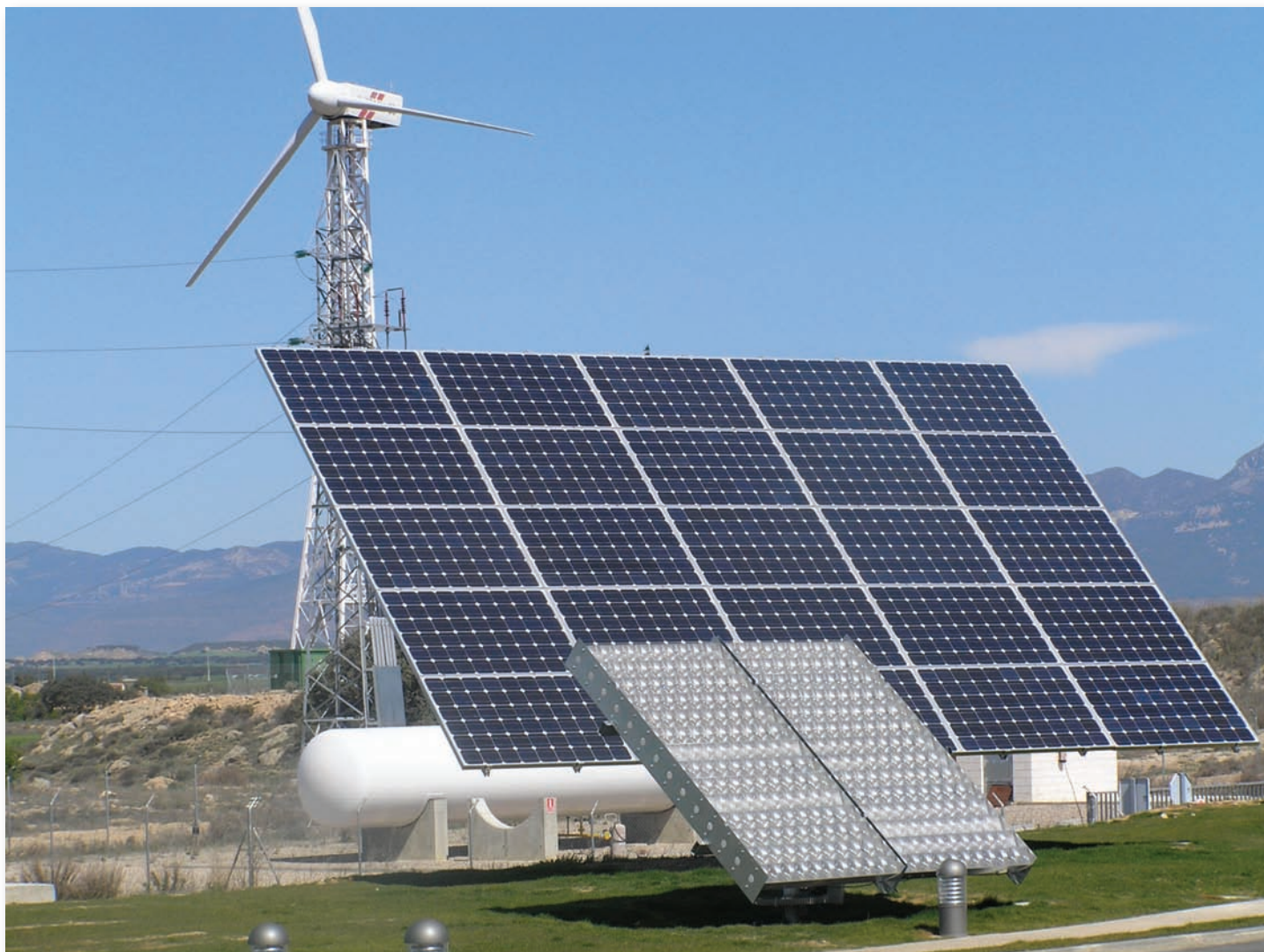
Instalación fotovoltaica en el Parque Walqa, sede de la Fundación
