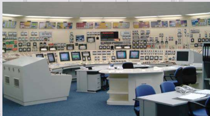
Simulador de la central nuclear de Vandellós 2
