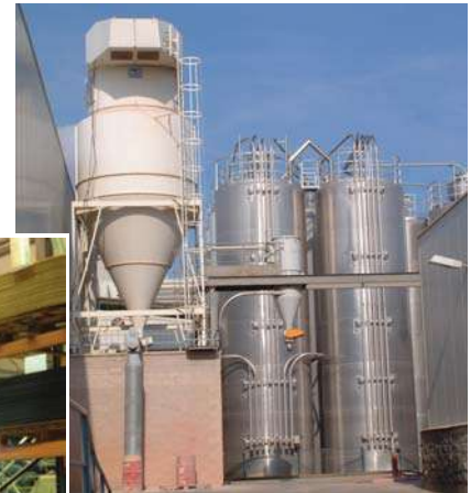
Vista exterior de la instalación de dosificación automatizada
