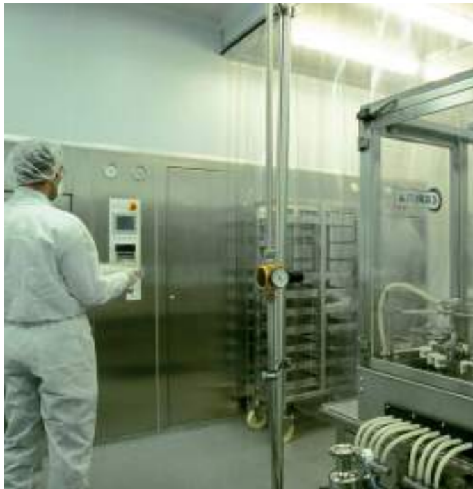
Sala acondicionamiento material primario
