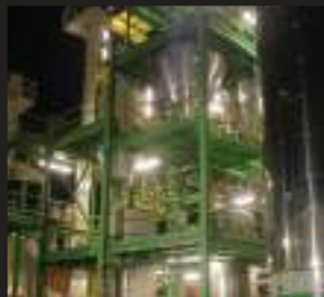
Vista general de la unidad de pretratamiento de la materia prima
