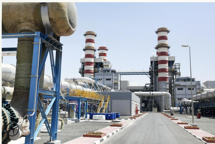
Dewa's M Station, la mayor planta de producción de energía y desalinización de agua en los Emiratos Árabes Unidos. Fuente: The National.
