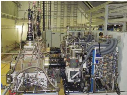
IFMIF RF System, Rokkasho, Japan
